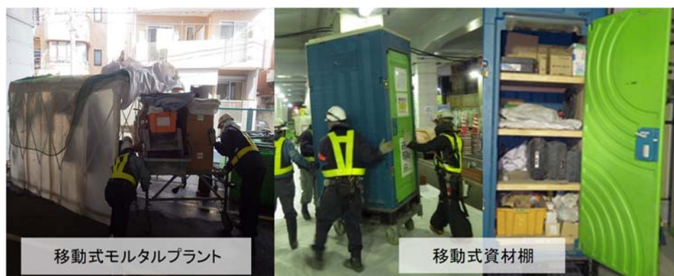
写真-3 移動式プラント・資材棚
