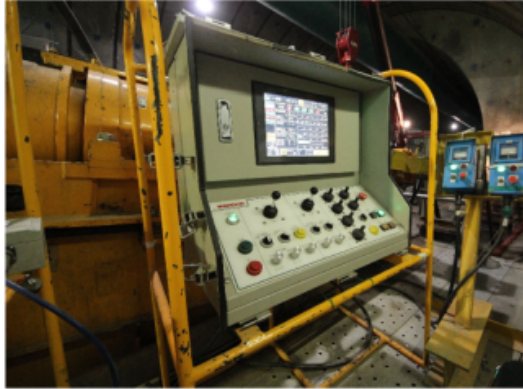
【ボーリングマシン制御ユニットのコントロール盤】
