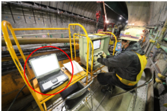
【孔曲り計測用パソコン】
