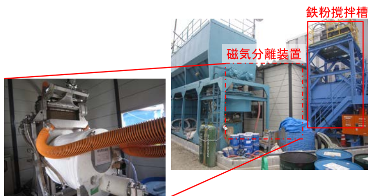
写真-3 鉄粉洗浄設備
