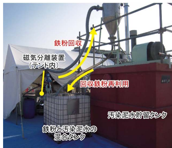
写真-2 浄化実証実験状況
