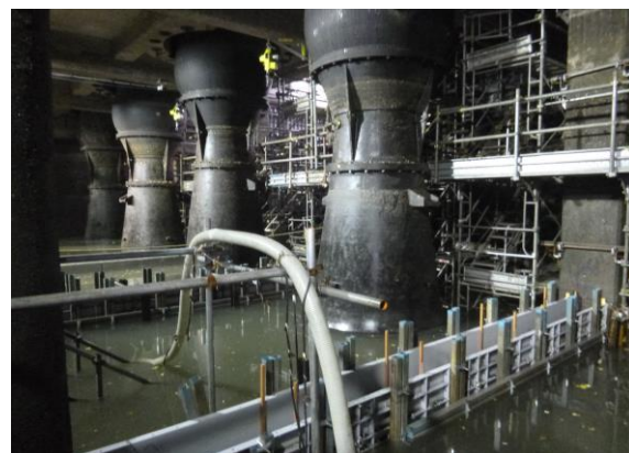
写真-11 ポンプ井水没状況
