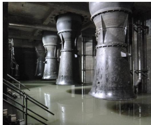
写真-1 雨水ポンプ井
