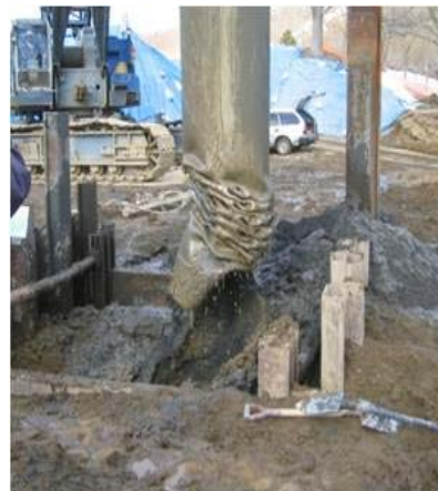
写真-2 過打撃した杭先端座屈
