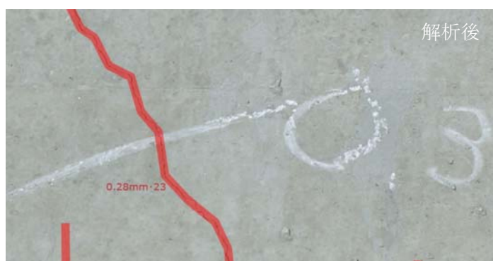
写真-6 目視によるひび割れ幅との比較
