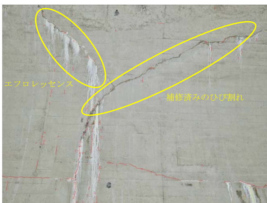
写真-7 補修済み及び析出物のあるひび割れ
