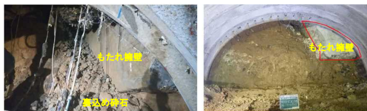
写真-12 もたれ擁壁の裏込め砕石の流出状況（測点 No. 39+8 付近）
