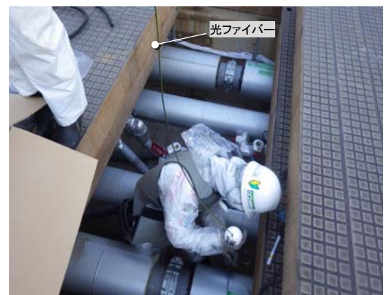
写真－6 光ファイバー設置状況(陸側遮水壁)
