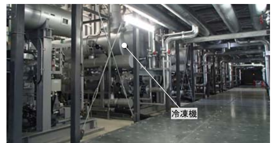
写真－7 凍結プラント建屋内の冷凍機
