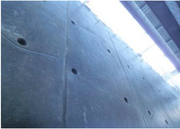
写真-4 透水型枠使用箇所が生じたしわ痕
