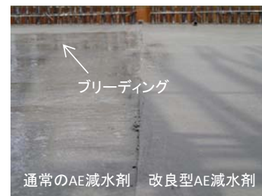
写真-2 ブリーディング発生状況
