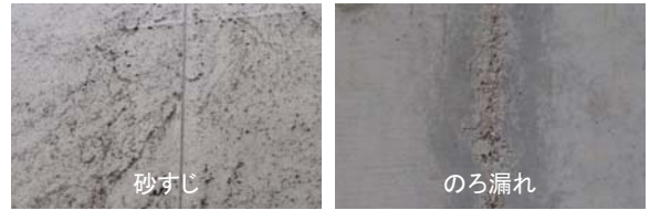
写真-1 表層の変状
