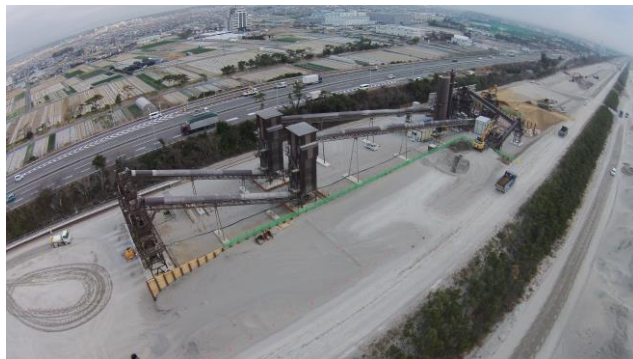
写真-1 大規模連続式 CSG 製造プラント
