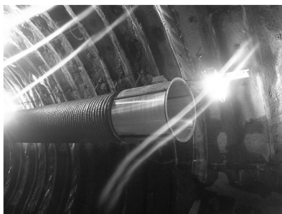
写真-12 伸縮風管
