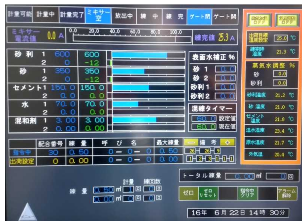
写真6 制御盤の操作パネル画面
