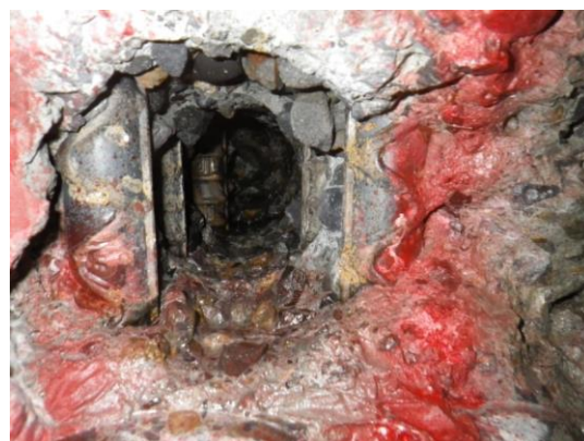
写真-6 既設鉄筋の支障状況
