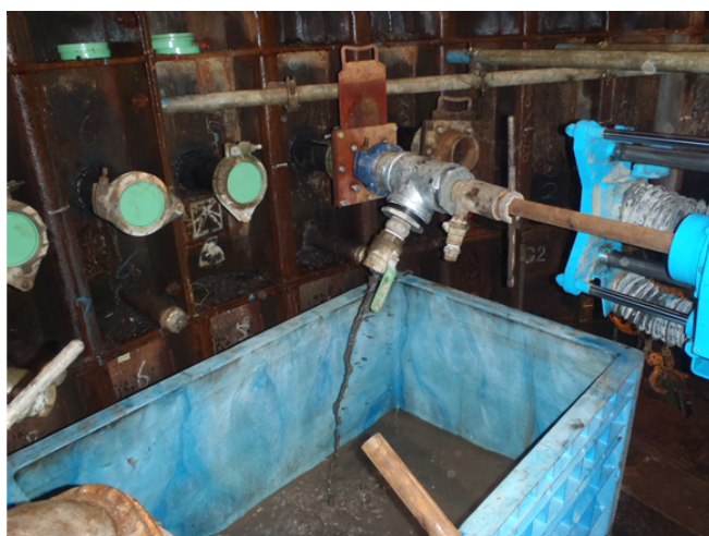
写真-3 対策前排泥状況
