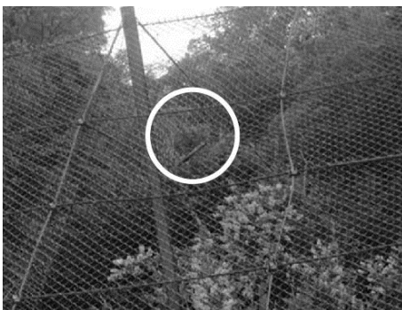
写真 1 既設ロックネット破損状況
