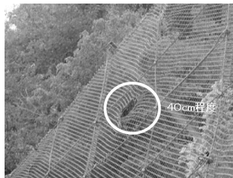
写真 2 既設ロックネット破損状況
