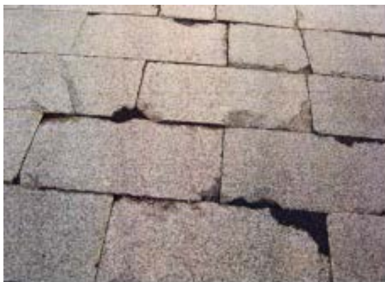
写真-1 ブロックの角欠け
