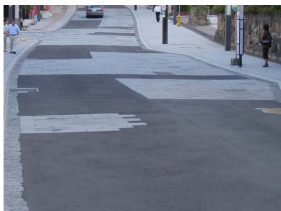
写真-4 補修事例(黒い部分がパッチング)
