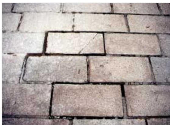
写真-2 ブロックの割れ
