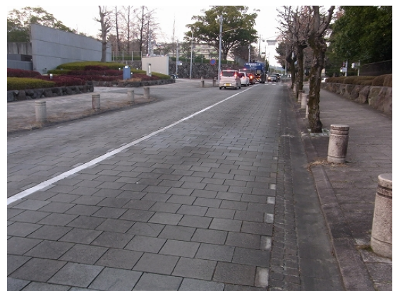
写真-8 施工後 20 年が経過した舗装の状況
