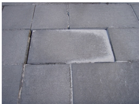
写真-3 ブロックの沈下
