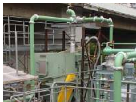
写真- 10 サイクロン設置状況
