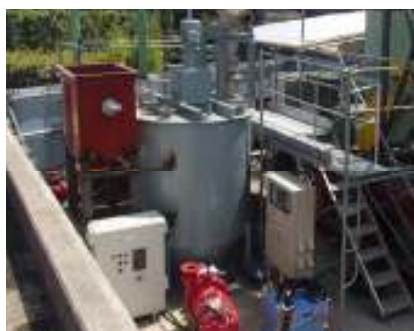
写真- 8 ヒ素吸着槽外観
