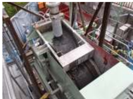
写真- 14 ドラム型磁選機処理状況
