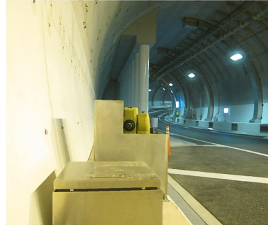
写真-4 自動計測器（トータルステーション）
