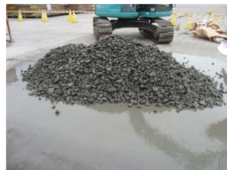
写真-1 コンクリート殻の状況
