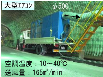
写真-7 大型エアコン
