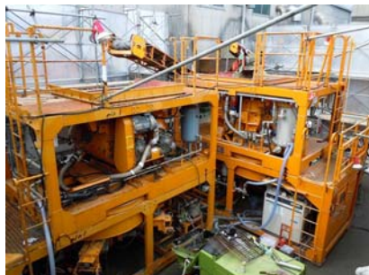
写真-2 流動化砂製造プラント
