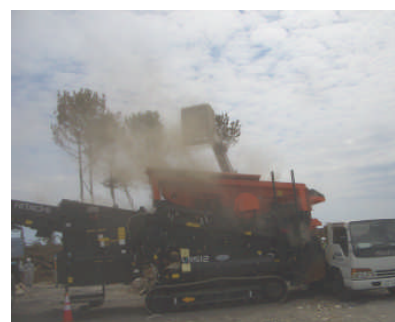
写真-6 粉じん発生状況（生石灰）
