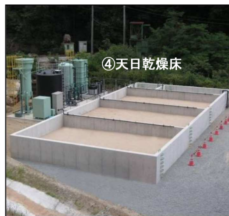
写真-3 天日乾燥床全景
