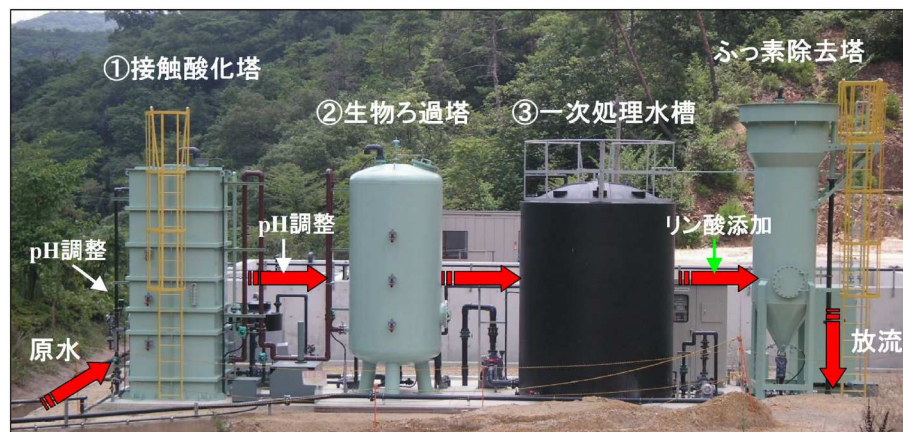
写真-2 水処理プラント全景
