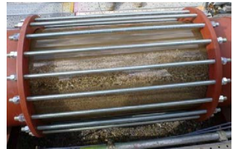
写真 11 管内堆砂状況
