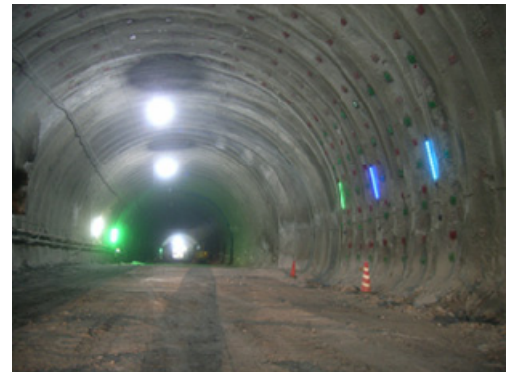
写真-5 変状部における設置状況 3)
