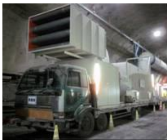
写真-3 集じん機の外観
