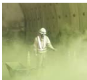
写真-6 粉じん発生状況
