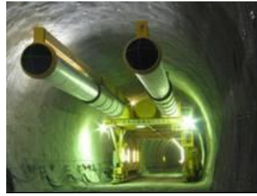
写真-1 峰山トンネルの換気システムの実機
