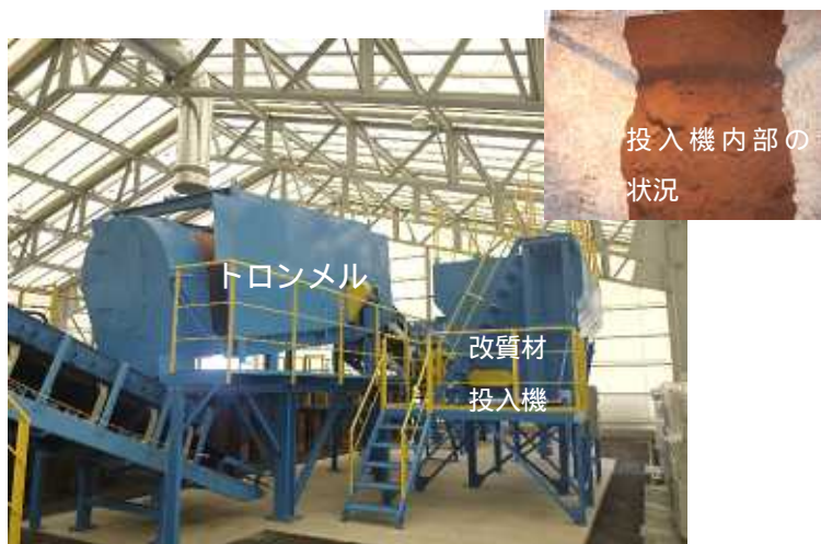
写真-8 改質材添加プラント
