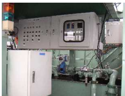
写真-3 水処理施設制御・監視盤
