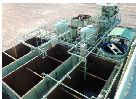
写真-2 水処理施設
