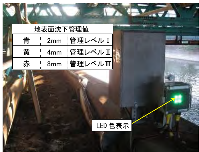
写真-1 管理レベル LED 表示状況
