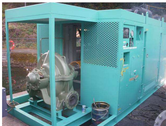
写真-2 超高压ポンプ
