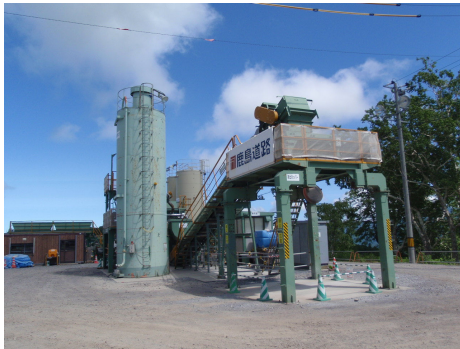
写真-4 プラント全景
