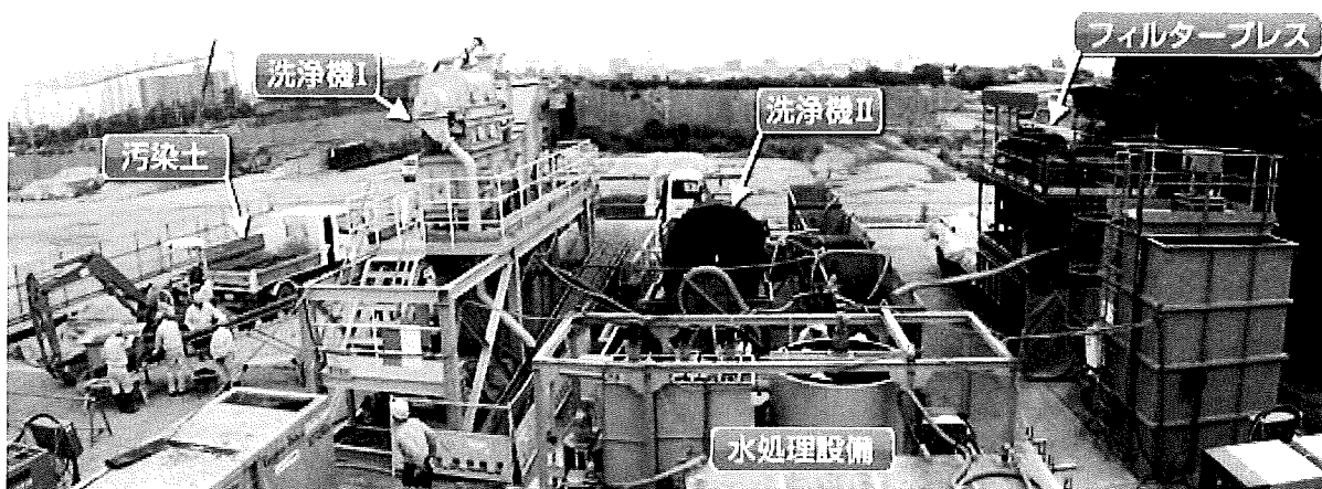
写真-1 実証試験プラントの全景
