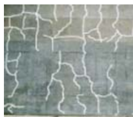
(1) 床版下面のひびわれ
