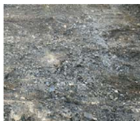
(2) スケーリング
