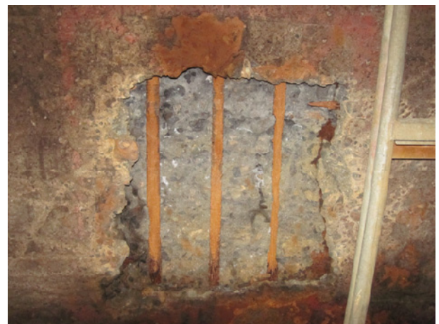
写真-9 浮き部 鉄筋腐食状況
