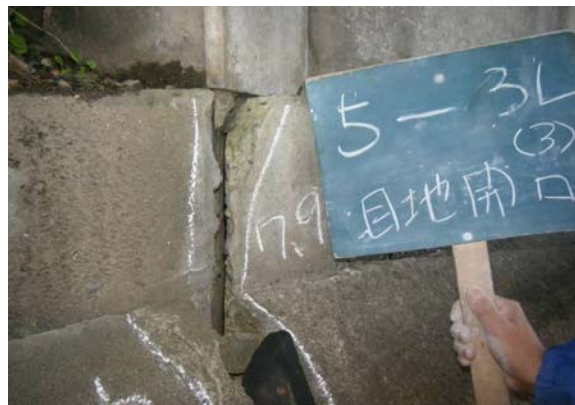
写真-1 散見される変状例
