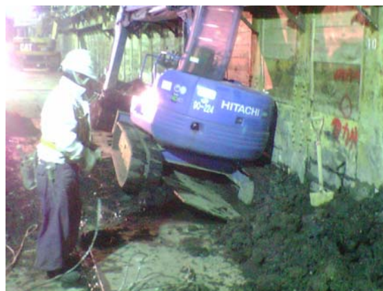
写真-1 トラフィカビリティー不足状況
