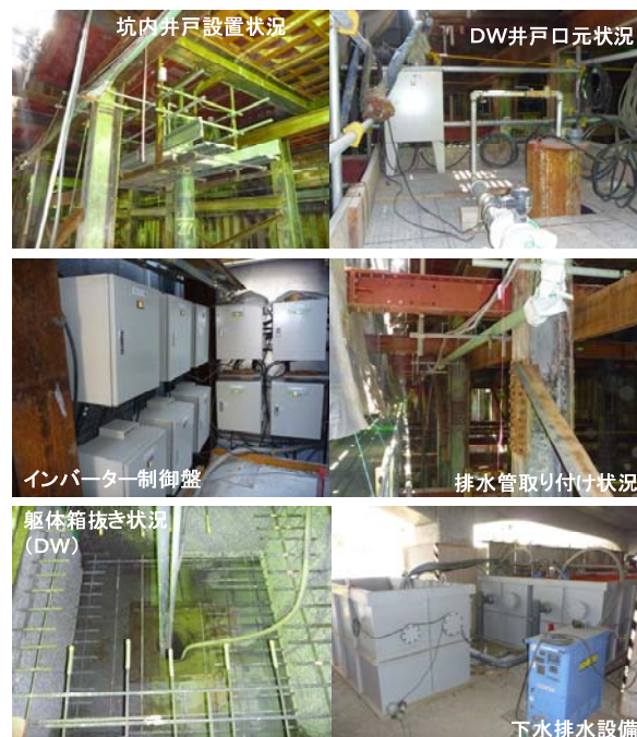
写真-3 井戸設備
