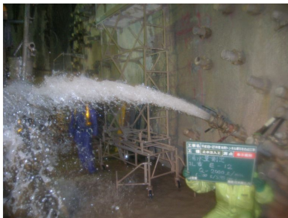
写真-4 注入孔の湧水状況 (Q=2t/分)
