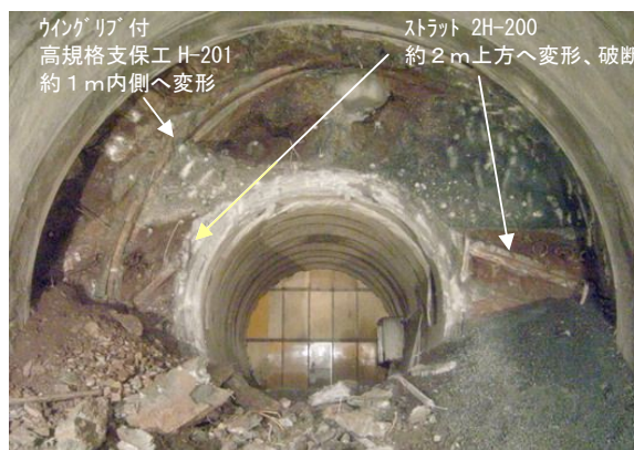
写真-5 崩壊部切羽状況
