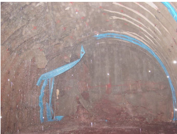
写真-1 2002年5月 1回目崩壊状況
