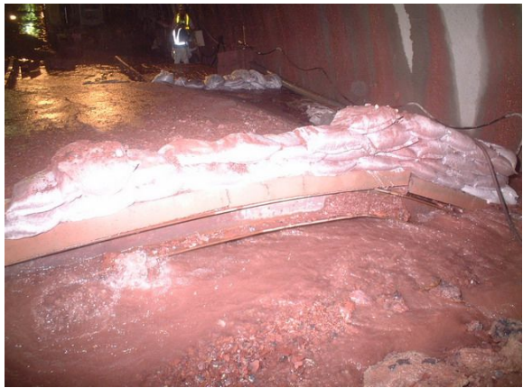
写真-2 2003年1月 2回目崩壊状況
