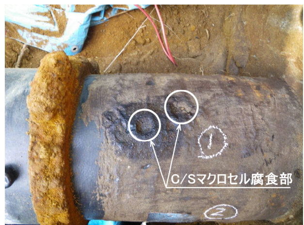
写真-1 C/S マクロセル腐食状況
