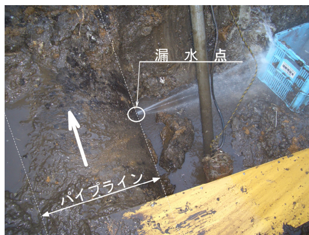
写真-2 計測施設での漏水
