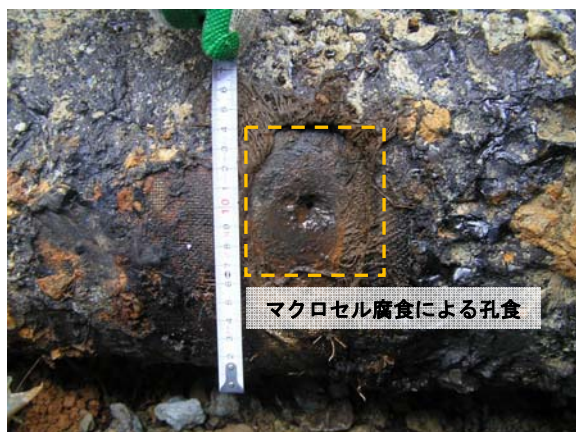
写真-1 鋼管のマクロセル腐食状況
