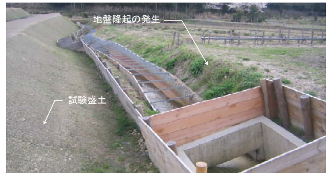
写真-1 試験盛土法尻付近の変形状況
