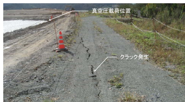
写真-4 地表面クラックの発生（鳥浜②載荷盛土）
