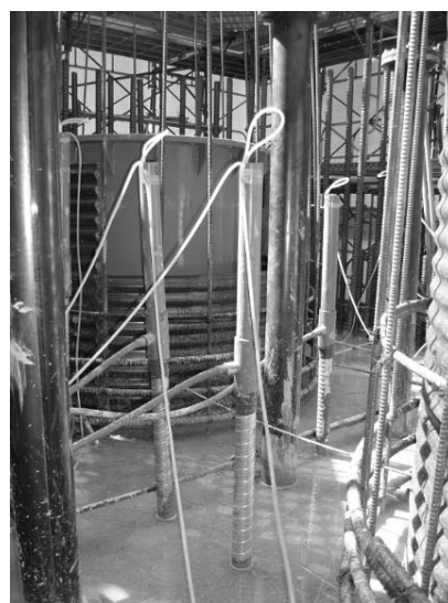
写真-3.3 冷却水回収装置
