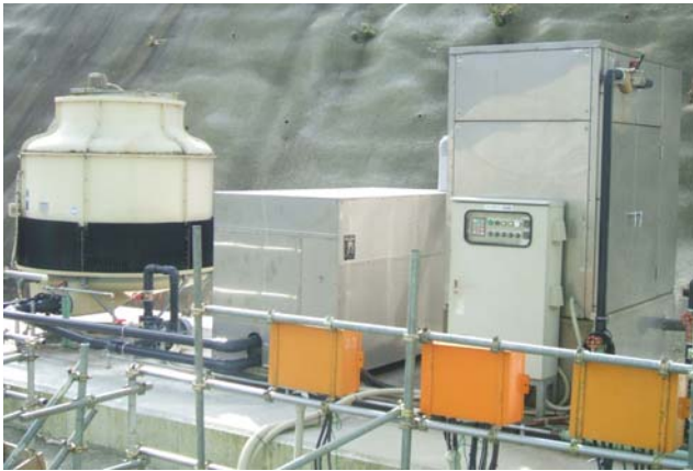
写真-1 練混ぜ水冷却設備
