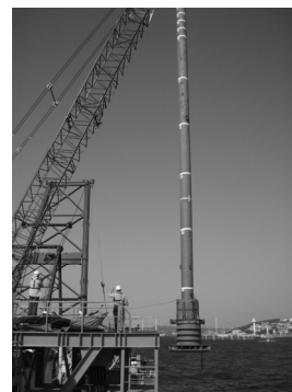
写真-3 レスキューシャフト
