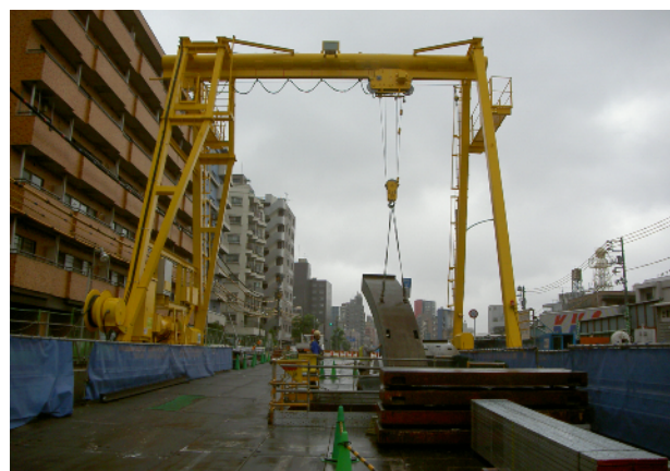
写真-8 門型クレーン
