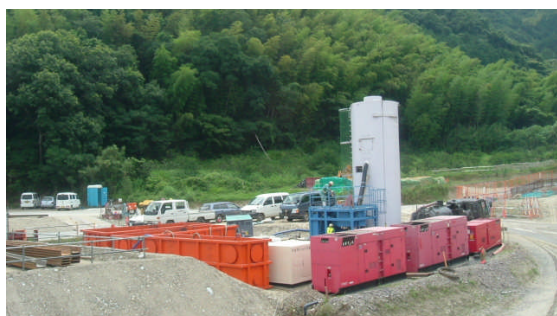
写真-16 プラント全景
