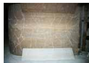
(b)水路内変状状況
