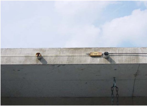
写真-5 センサーの設置状況
