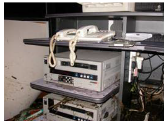
写真-5 スリランカ海洋資源研究所の機器被害
