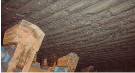
写真-1 カッタービットによる切削跡
