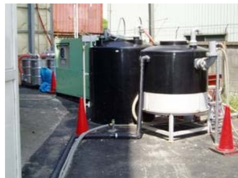
写真-12 水処理設備
