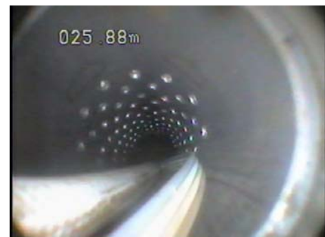
写真-10 井戸管内
